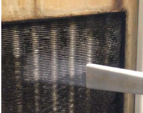
Matériel de ventilation
